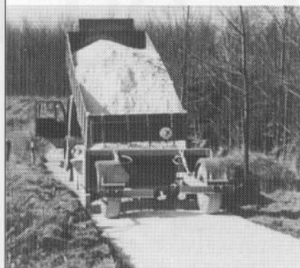
Levering og udlægning af grus, sten og andre vejmaterialer direkte fra lastbil med patentanmeldt vejafrettermaskine.
